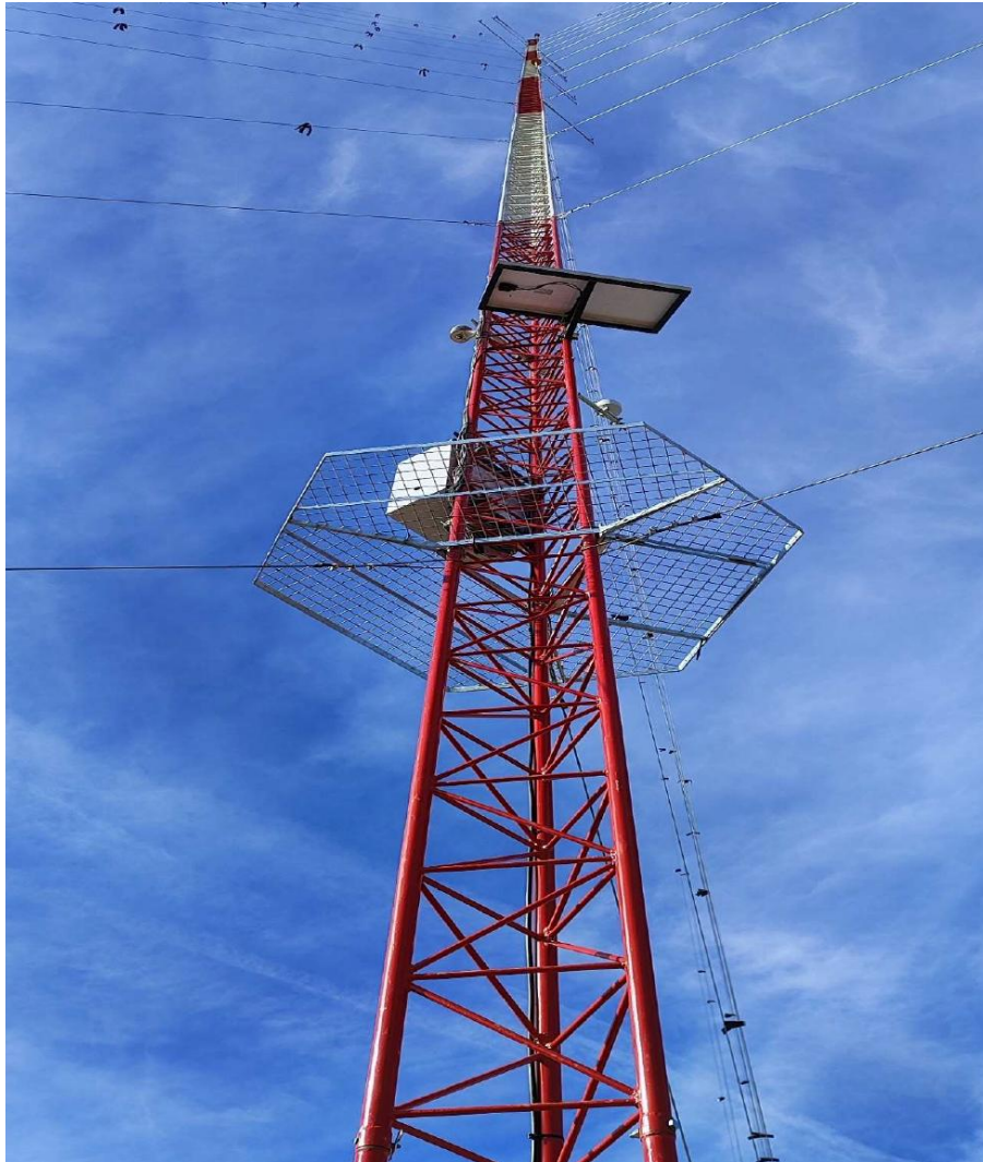
Figura 7: Ejemplo vallado torre de referencia y calibración
